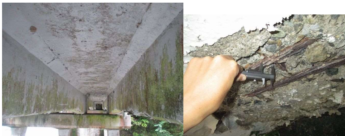
剥離・鉄筋露出（健全度Ⅱ） 1930年架設
