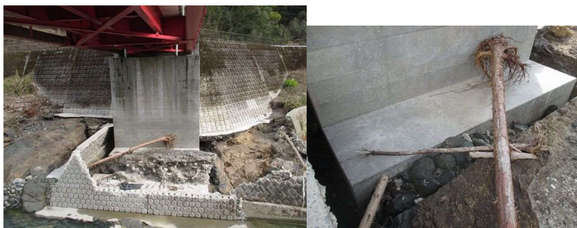
洗掘（健全度Ⅲ）2008架設
