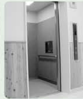
エレベーター
