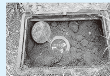
メーターが土に埋もれて確認時に支障があります
