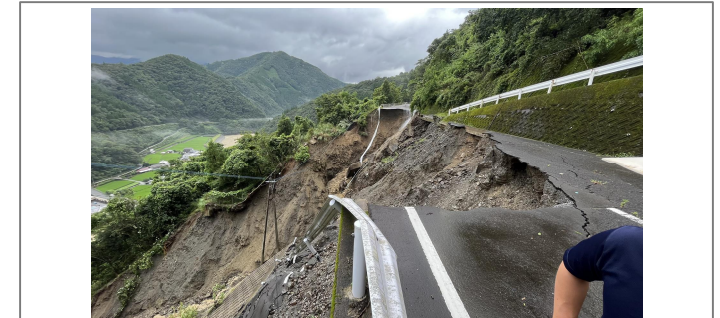
【状況写真①】 林道宇目・須木線よりの崩壊状況(終点から)
