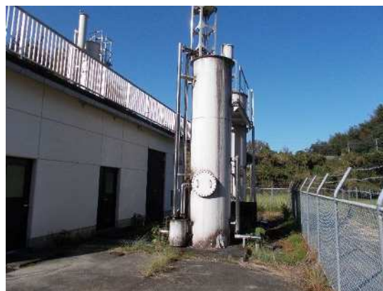
上野原浄水場（急速ろ過機）
