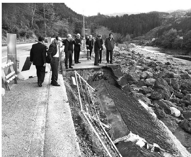
▲鬼神野地区市谷（歩道の崩壊）
